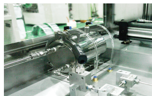
공정 후 배출되는 배관에 냉각 장치를 설치, 챔버(Chamber) 통과 후 발생하는 열로 인한 시료의 손상 방지
