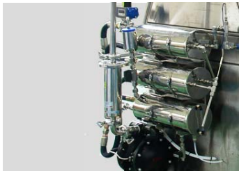
비가동시 원료의 고형화 방지를 위한 Solution 저장 탱크 및 자동밸브 장치
